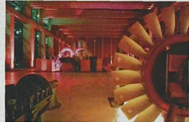
Schöner Strom erzeugen: Im Kraftwerk Staudinger
